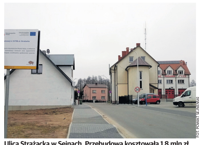
Ulica Strażacka w Sejnach. Przebudowa kosztowała 1,8 mln zł. Nie tylko wymieniono nawierzchnię, ale i przebudowano kanalizację, zbudowano kanał technologiczny, nową linię oświetleniową. Inwestycja została dofinansowana z RPO WP 2014-2020.
